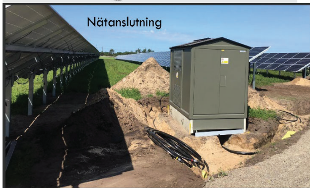
Figur 9 - Vänster: Exempel på växelriktare. Höger: Exempel på transformator- och uppsamlingsstation.
