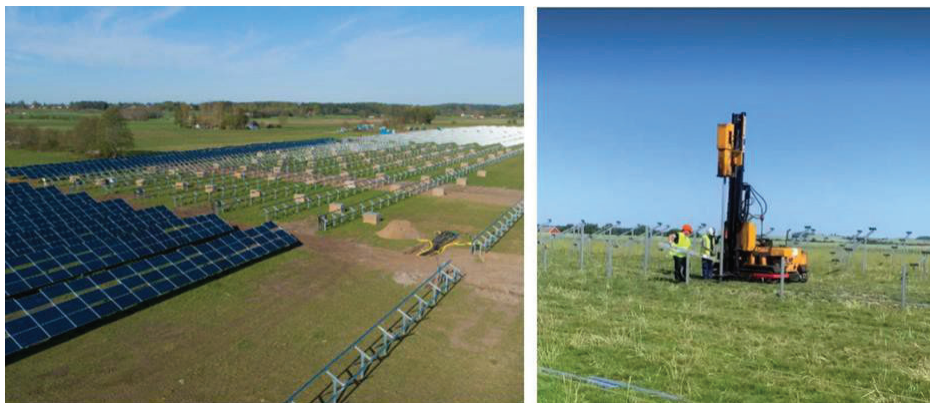
Figur 8 - Vänster: exempel på montage av solpaneler på markställningar. Höger: Pålning med pålningsmaskin.
