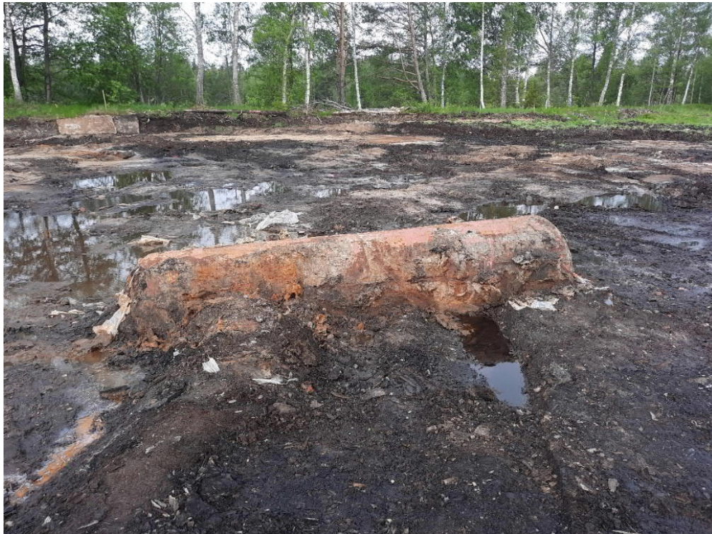
Figur 4: Fotografi av liggande cistern, svagt lutande. Manlucka ligger i sidled, bort från bilden) och den vänstra änden av cisternen (mot sjön) är lägre placerad än cisternens högra ände. Slutlig bedömning är att cisternen inte nyttjades i den placering som den nu påträffas. Vatten som syns i bilden är nederbörd som föll under dagen för platsbesök. Enligt entreprenör och miljökontrollant var vattnet borta dagen efter.
