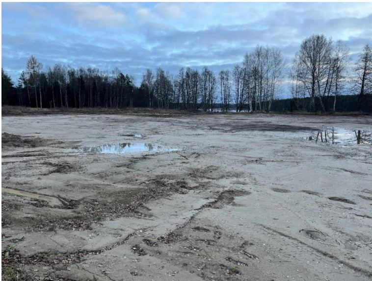
Figur 6a: Fotografi taget åt syd vid slutbesiktning, mot sjön Multen. Fotograf står på Brädgårdsvägen.
