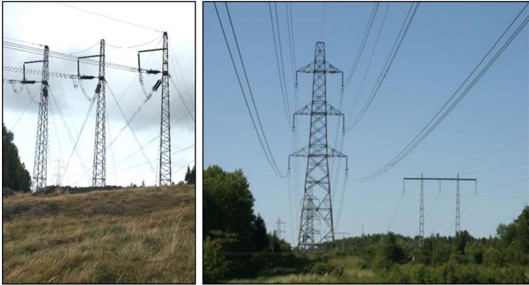
Figur 13. Bild på vinkelstolpe (vänster) samt julgransstolpe bredvid en portalstolpe (höger).
