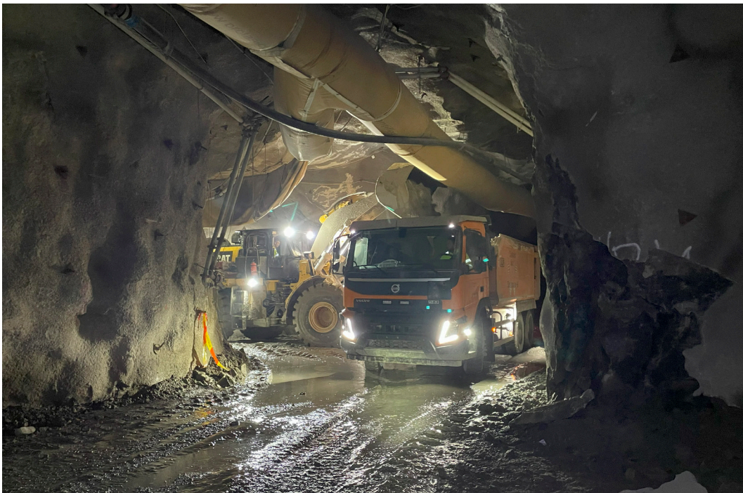
Fig. 26. Med jämna mellanrum (ca. var 150:e meter) utökas tunnelns sektion för att rymma last- och mötesplatser. Notera bergförstärkningsåtgärder i tunnelns tak och väggar, med både sprutbetong och bergbult. Från Zinkgruvan. Foto: Albin Månsson.
