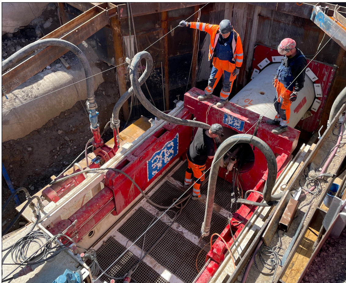
Fig. 22. Rörtryckning med mikrotunnelborrning. Hydraulerna (röda i bild, eng. thrusters ) har nått sin fulla längd framåt. Förberedelser vidtas för att dra tillbaka hydraulerna, sänka ner och montera ytterligare ett betongsegment. Rörledningar för slurry och elförsörjning kopplas tillfälligt isär för att monteras efter det tillkommande betongsegment. Foto: Albin Månsson.
